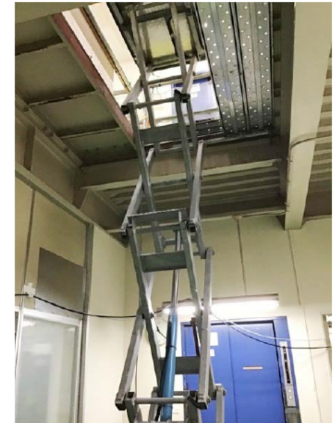
エレベータ故障にて 昇降機を仮設
