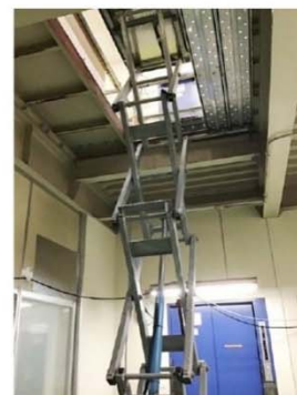
エレベータ故障にて 昇降機を仮設
